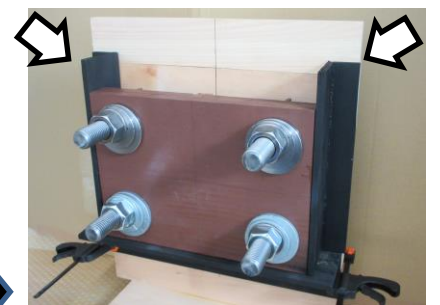
●15 「注入枠(側板)」の設置 ※グラウト材の漏れに注意 ※鋼製の場合もある
